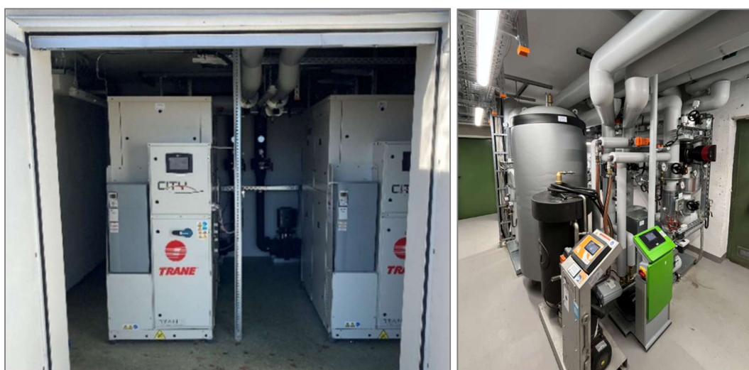
Abbildung 65: Wärmepumpenanlage (links) und Blick in den neuen Heizraum (rechts)
